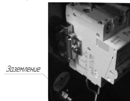
Заземление Автоматический выключатель напряжения питания 220В
